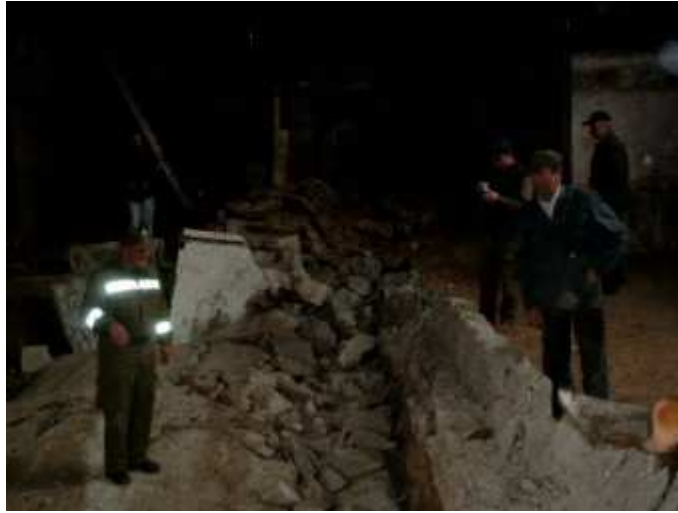
...und die Mauer liegt in Schutt
