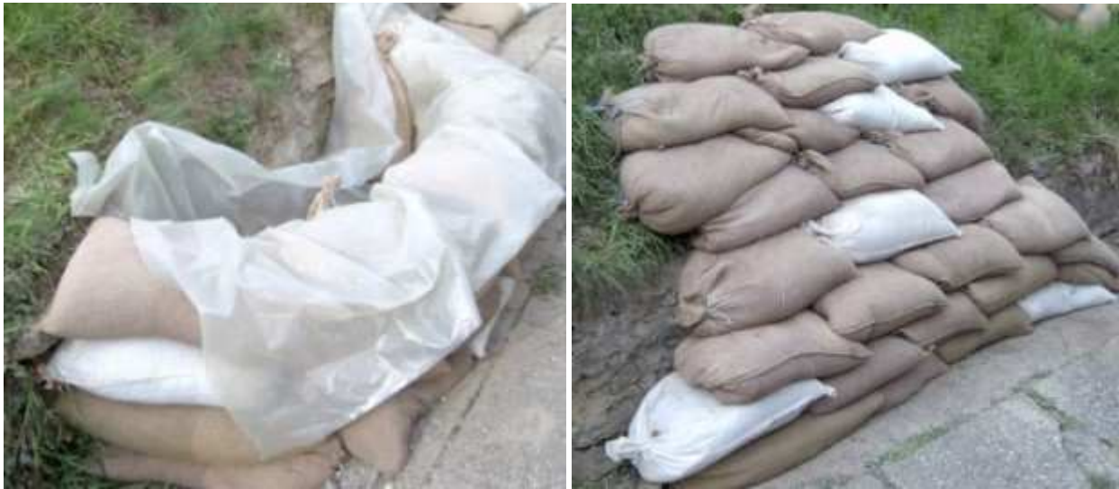
Verstärkung des Dammfußes (beim linken Bild ist der Hohlraum noch mit weiteren Sandsäcken oder losem Sand zu verfüllen)
