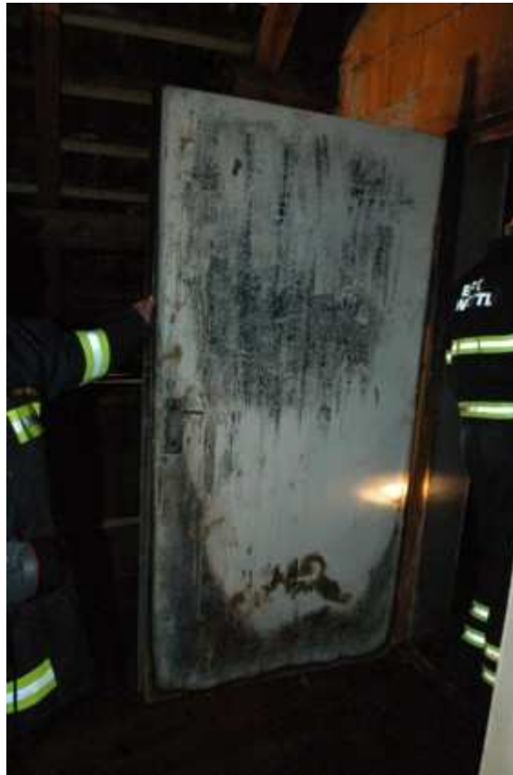
Die Brandschutztür zum benachbarten Dachboden hat ihren Zweck erfüllt.
